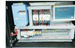
电路控制板 circuit control panel
